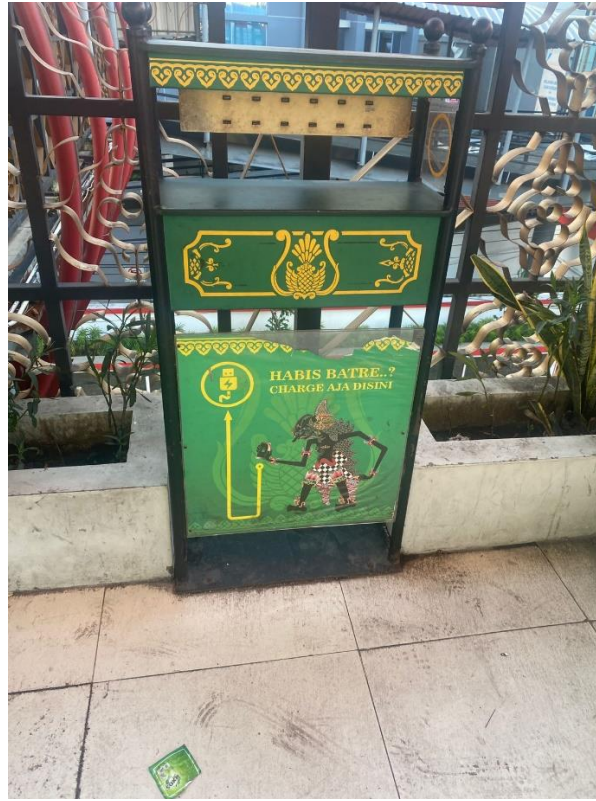
Foto keadaan fasilitas stop kontak kelistrikan pada Jembatan Penyebrangan Orang (JPO) Gldhag Panti Husada SOLO yang tidak terawat
