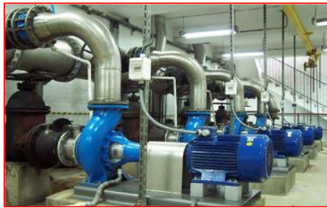
Gambar 1.1 a : Instalasi Pompa Sentrifugal di sebuah
