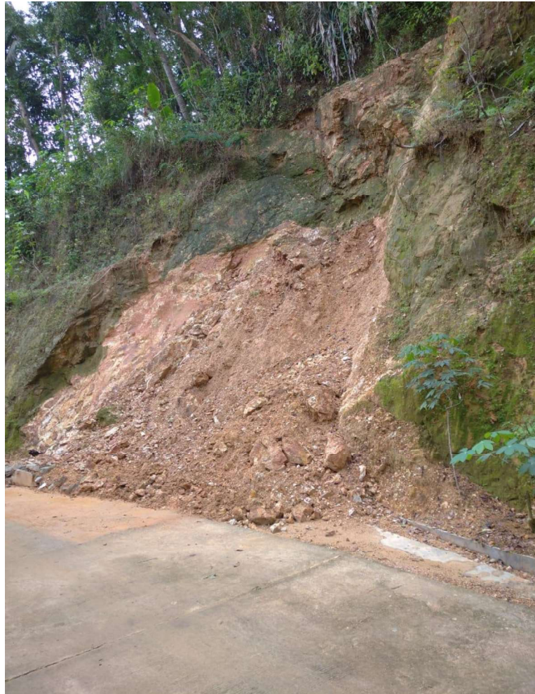
Gambar 1. 5 Kondisi Lereng Pada Salah Satu Sisi Jalan
