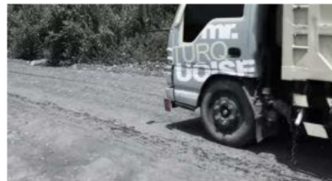
Gambar 4. Kondisi jalan angkut yang tidak memiliki paritan
