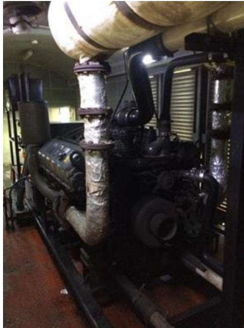
Gambar 10. 1 Ruang Pembangkit Listrik Kereta
